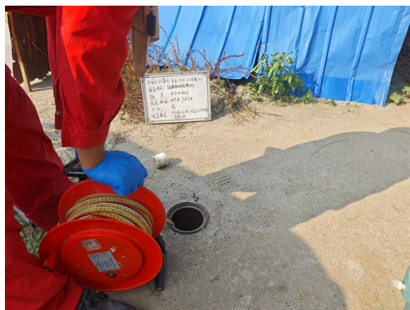
KSW005-测量水位
